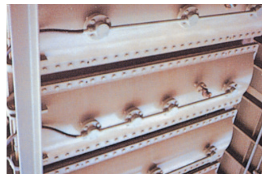
外部電源方式による防食中のガスクーラー
