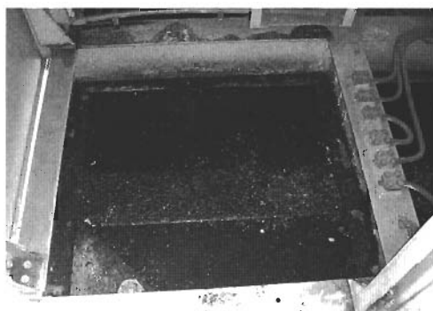
写真-1 建屋内雨水浸入状況
