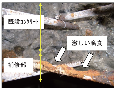
図2 床版部の再劣化
