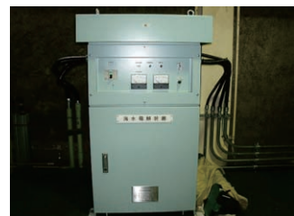
写真2 直流電源装置
