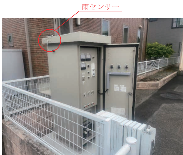
図3 雨天時自動切換装置付き外電
